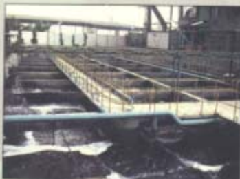
Instalasi Pengolahan Air Limbah
